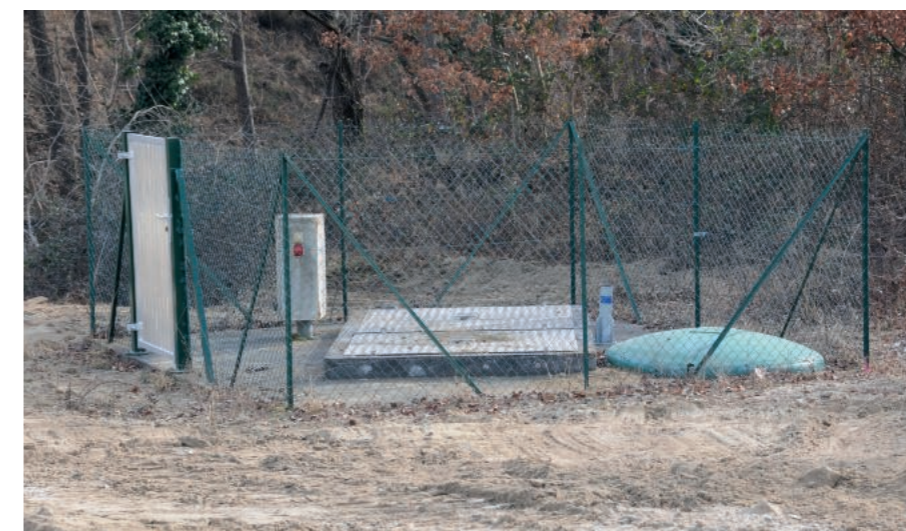
Poste de pompage sécurisé
