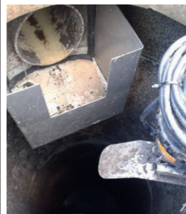
Trop plein du poste de relevage
