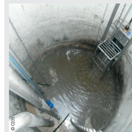
Poste de pompage équipé d'un panier dégrilleur et des poires de niveau
