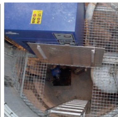
Poste de refoulement pneumatique avec pompe
