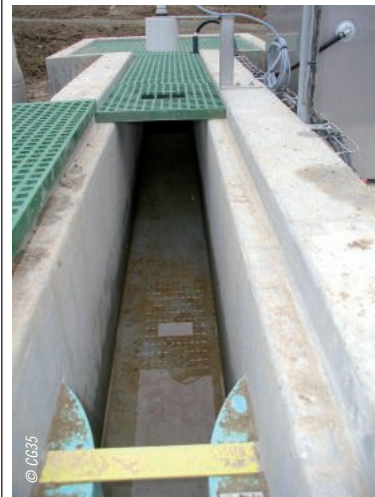
Un canal de mesures de débit normalisé et instrumenté permet de connaître les volumes reçus sur la station.
