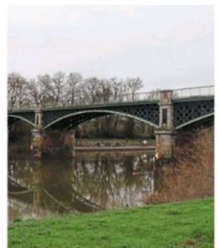
Le pont Napoléon-III situé à Port-de-Roche entre Langon et Sainte-Anne-sur-Vilaine va devoir être remplacé.
